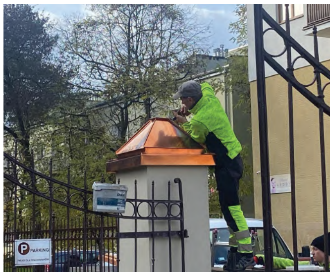
// Montaż miedzianej obróbki blacharskiej na słupach przy bramie wjazdowej na teren urzędu miasta.
