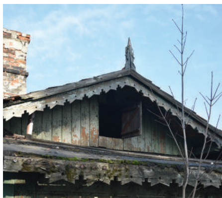
// Zniszczony dach dróżnicówki z ozdobnymi elementami.
